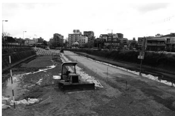
浚渫した川砂を運び出すため、トラック搬入用の取り付け道路をつくっています。
