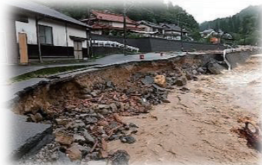
〈被災した道路〉
