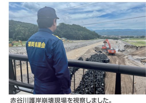
赤谷川護岸崩壊現場を視察しました。
